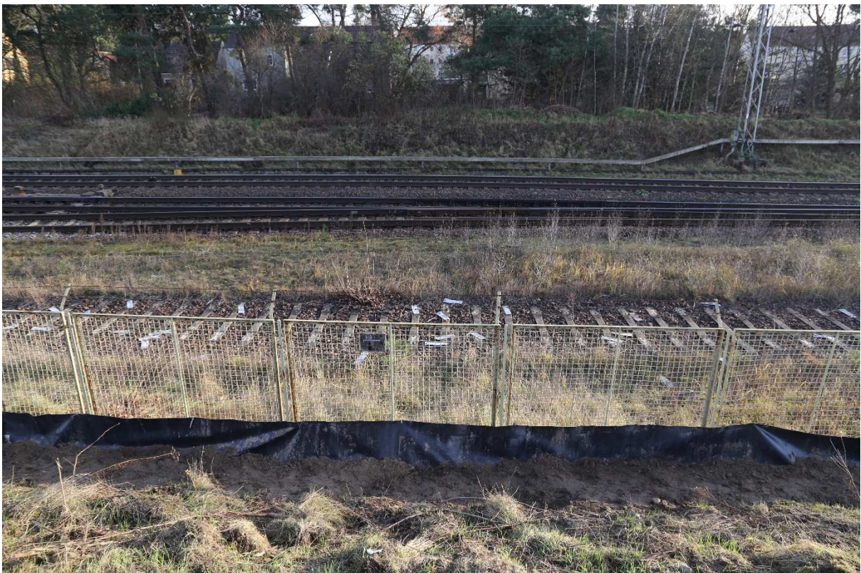
Abb. 24: Zur Vermeidung der Rückwanderung von Reptilien aus den Nachbarflächen der Bahn ist der Schutzzaun für die Bauzeit durchgängig funktionstüchtig zu halten.
