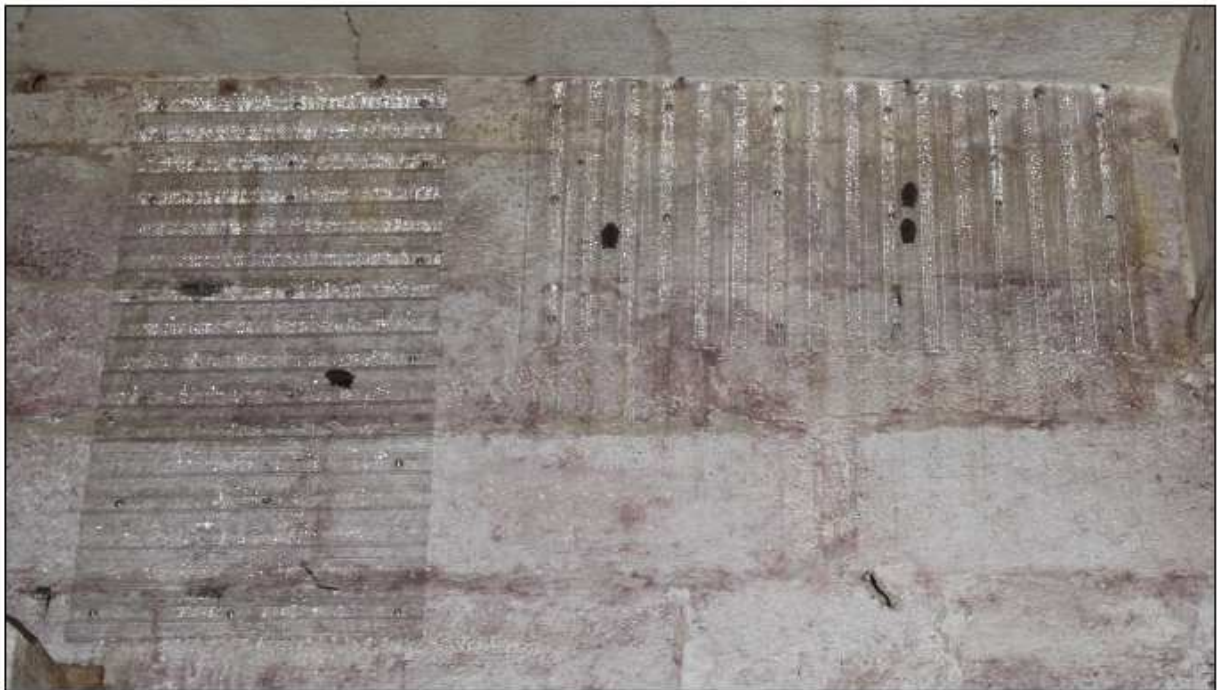
Abb. 3: Beispiel einer horizontal und einer vertikal an die Wand geschraubte Trapezlichtplatte. Die horizontale Trapezlichtplatte wurde an die Decke angeschlagen, um Zugluft in den Spalten der Trapezlichtplatte zu verringern. In der vertikalen Trapezlichtplatte befindet sich eine und in der horizontalen befinden sich drei überwinternde Fledermäuse (Abb. Matthias Götttsche)
